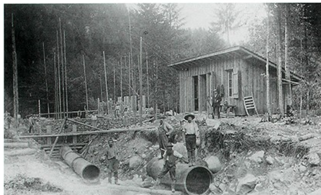
Wagemutige Vorväter: Ins damals fast unberührte Lorzentobel bauten sie das Wasserkraftwerk, die sogenannte Zentrale 1.
